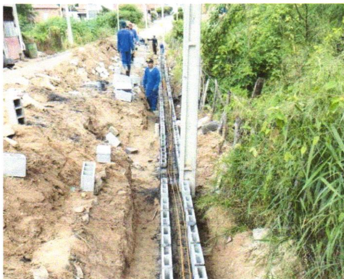
Foto 05 - ALVENARIA DE BLOCOS DE CONCRETO ESTRUTURAL 9X19X39 CM, (ESPESSURA 14 CM) FBK = 14,0 MPA, PARA PAREDES COM ÁREA LÍQUIDA MENOR QUE 6M 2 , SEM VÃOS, UTILIZANDO PALHETA. AF_12/2014
